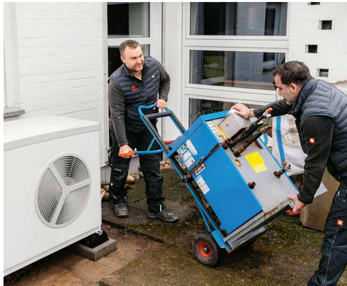
Alte Heizung raus, moderne Wärmepumpe rein: Dieser Umstieg zahlt sich gleich mehrfach aus.
