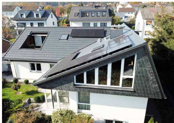
Photovoltaikanlagen auf dem Dach des Eigenheims tragen zu mehr Unabhängigkeit bei der Energieversorgung bei.
